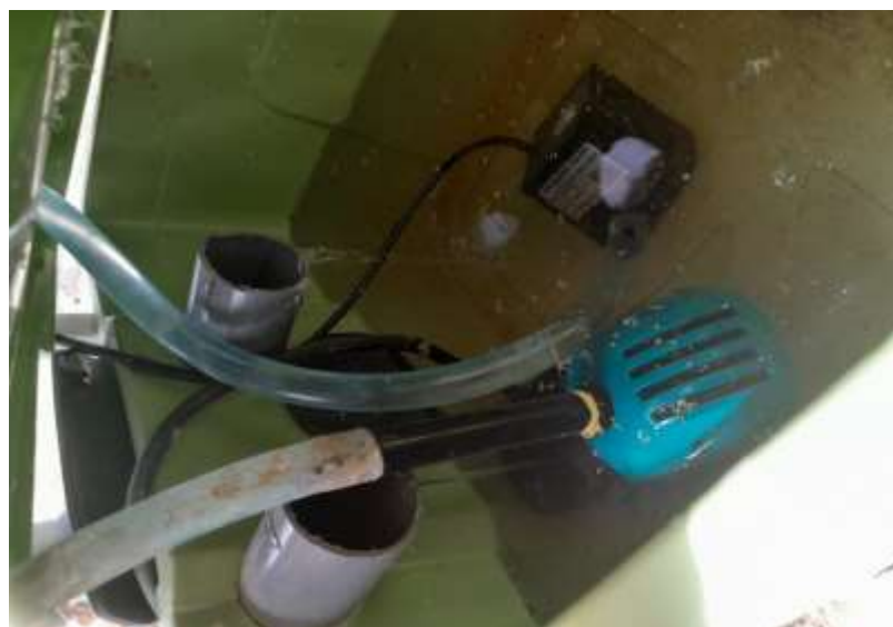
Figure 39 : fonction des pompes(Cliché Boufadi et Ouazzani, 2024)
