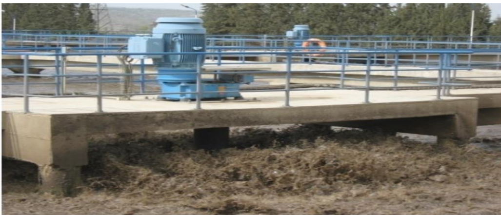
Figure 14 : Bassin d'aération STEP de Saida (Photo : ONA, 2025)
