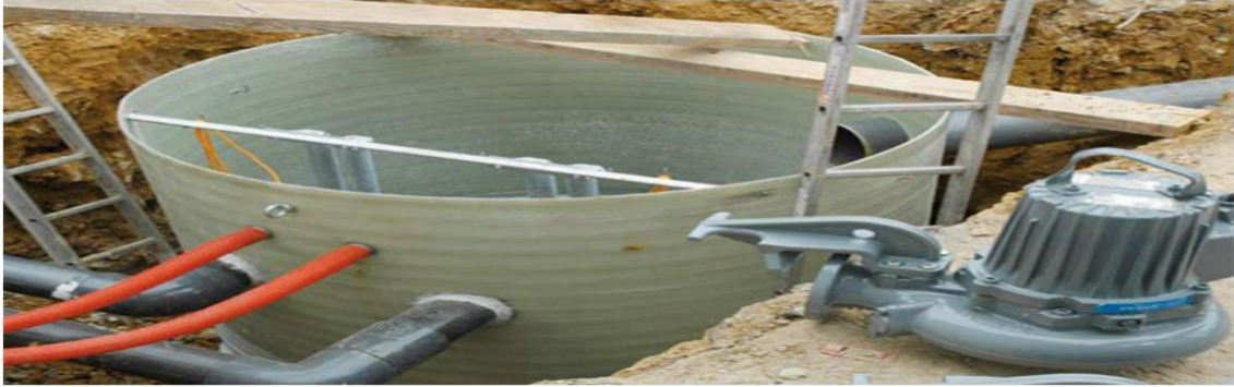
Figure 13 : unité de relevage STEP de Saida (Photo : ONA, 2025)
