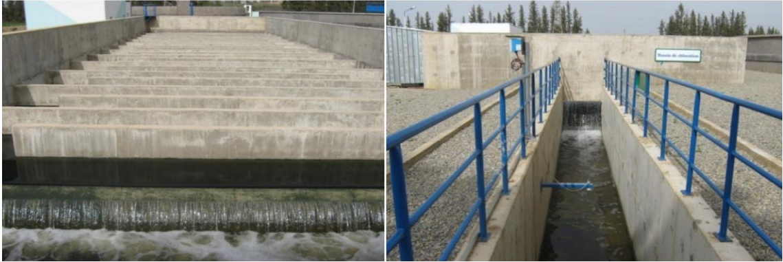
Figure 16 : bassin de chloration STEP de Saida (Photo : ONA, 2025)
