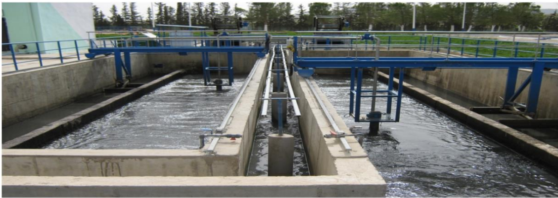
Figure 12 : unité de Dessablage et Déshuilage STEP de Saida (Photo : ONA, 2025)
