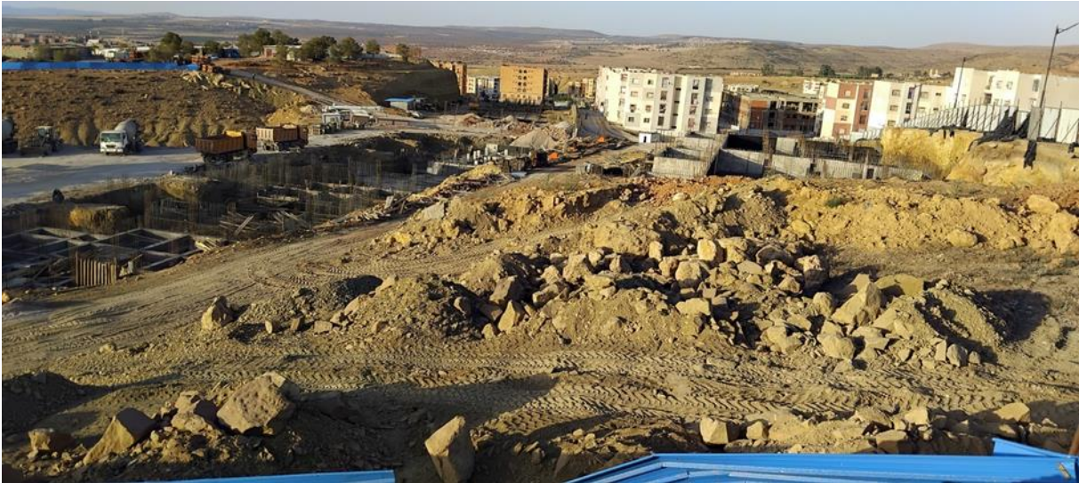
Figure 39 : travaux de construction de nouveaux complexes résidentiels par la face avant de forêt de Mkimen. (Amer et Brahim, 2024, Photo du 05/06/2024)
