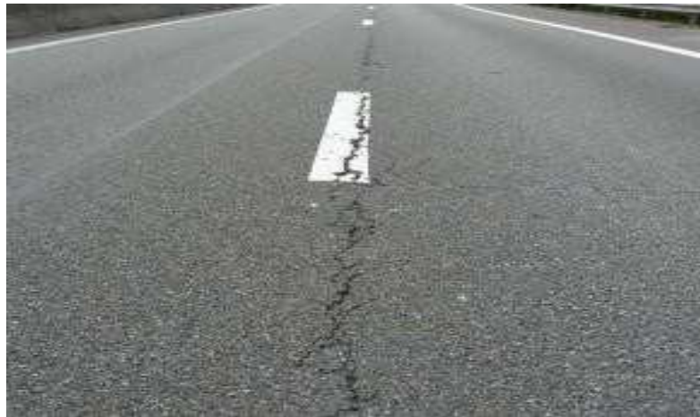
Figure II-5 : les fissures longitudinales.
