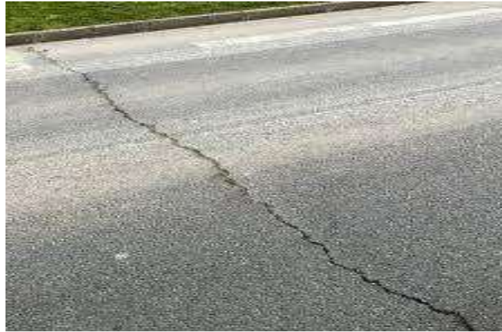
Figure II-4 : les fissures transversales
