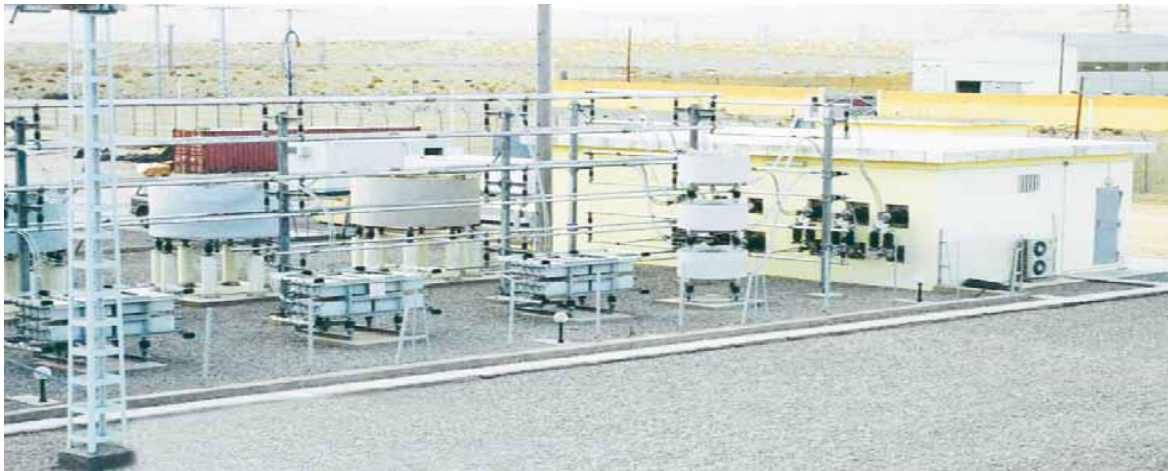
Figure II.3: Photo montrant l'une des Plates-formes des trois SVC de l'Algérie[18]
