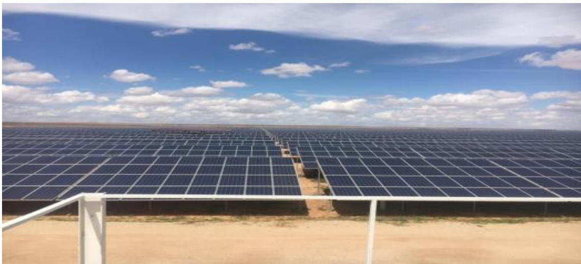
Figure I.11: les champs photovoltaïques de la centrale d'Ain Skhoua.[11]
