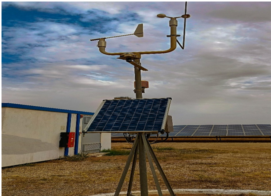
Figure.IV.6. Station de surveillance météorologique d'Ain Skhouna.
