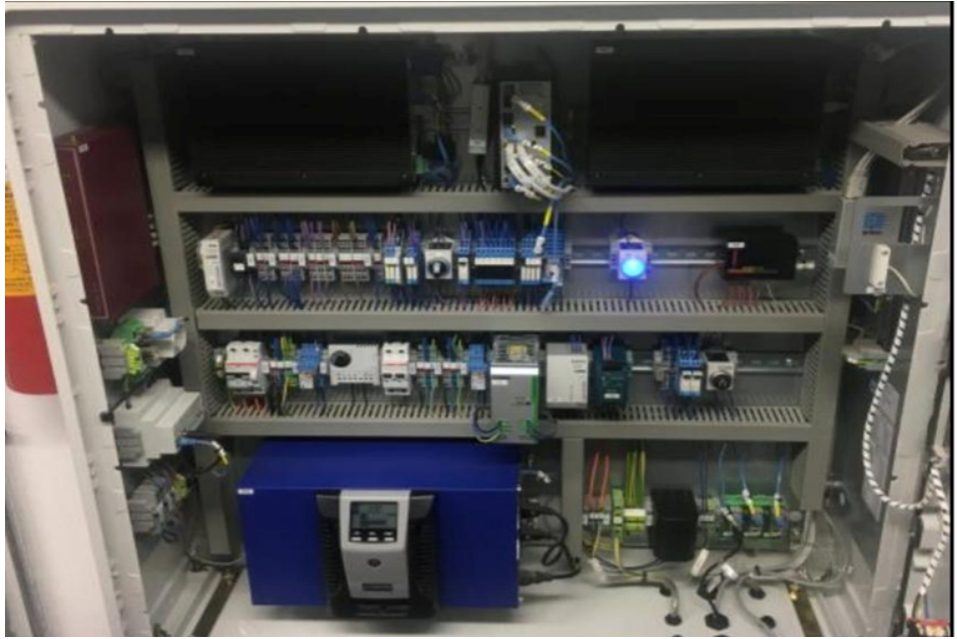
Figure.IV.5. Image de l'armoire de communication des charges
