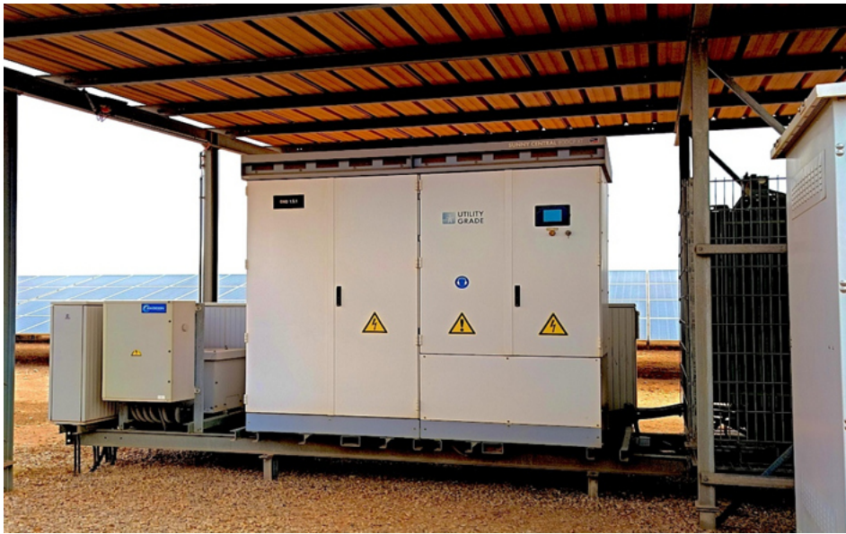
Figure.IV.4. Image illustrative de l'onduleur PV de type Sunny Central 850CP XT installé dans la centrale de Ain-Skhouna
