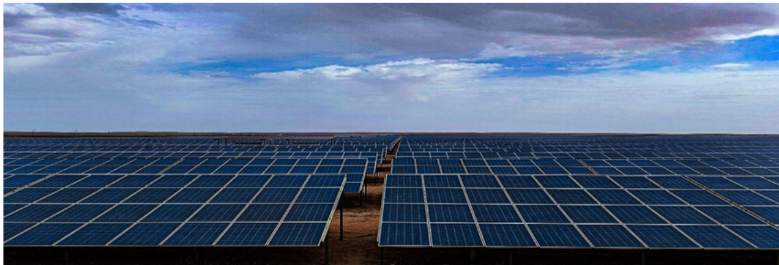
Figure.IV.1. Centrale PV de 30 MW de Ain-Skhouna Saida
