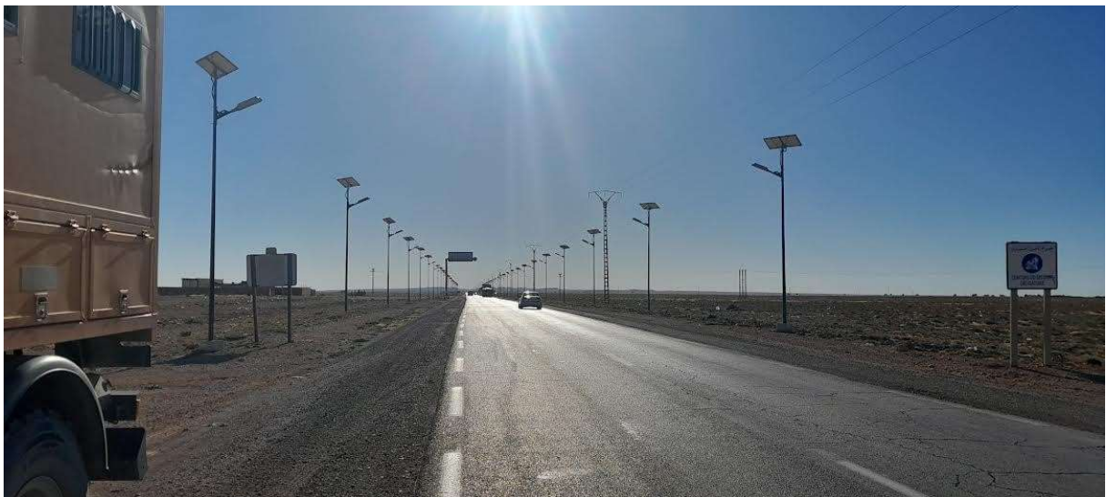
Figure III.2 : Photo réelle d'accès de ville Boughtobe (éclairage avec panneau solaire)
