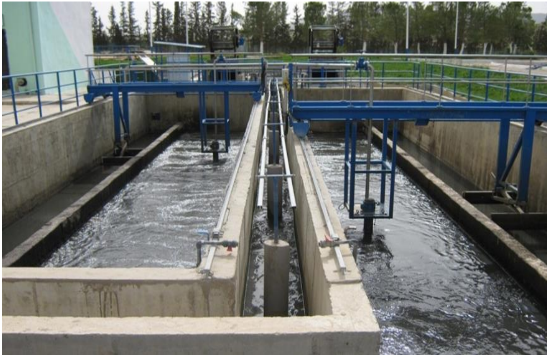
Figure I.8: L'opération Dessablage –Déshuilage
