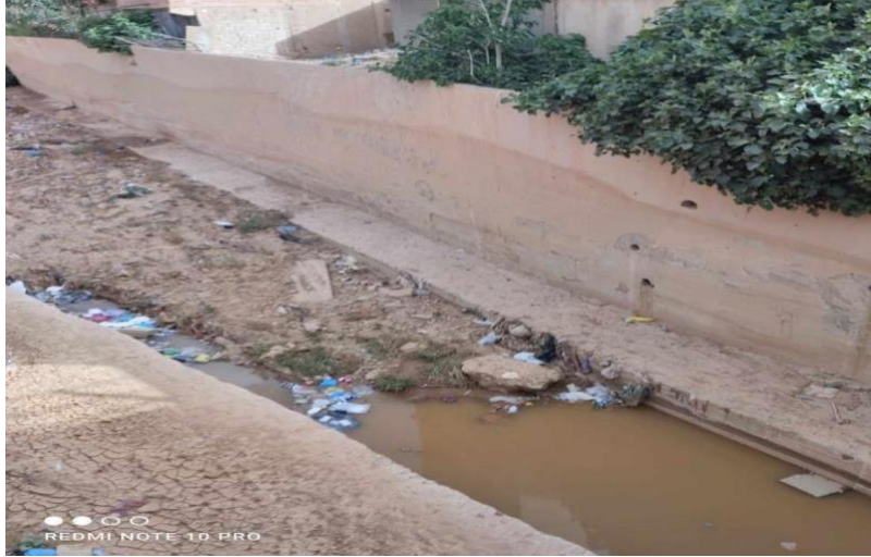
Figure 23 : Oued Deffa avec les voiles de protection en partie détruits (Photo original)
