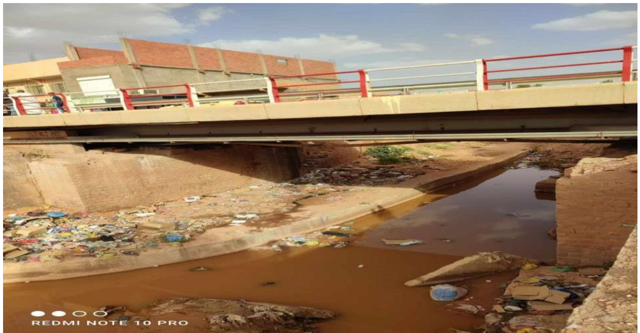
Figure 19 : Pont menant vers El Bayadh entrée de la ville avec une conduite d'AEP ( Photo original )
