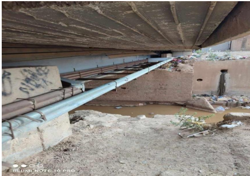
Figure 24 : Oued Deffa avec les voiles de protection en partie détruits (Photo original)
