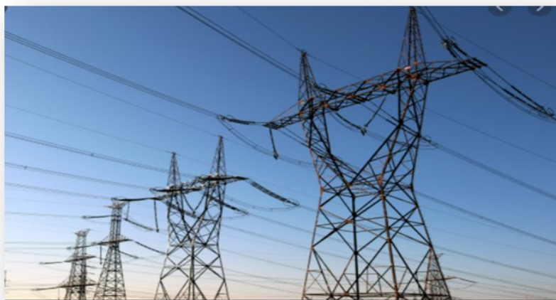
Figure (I.2) : lignes électriques
