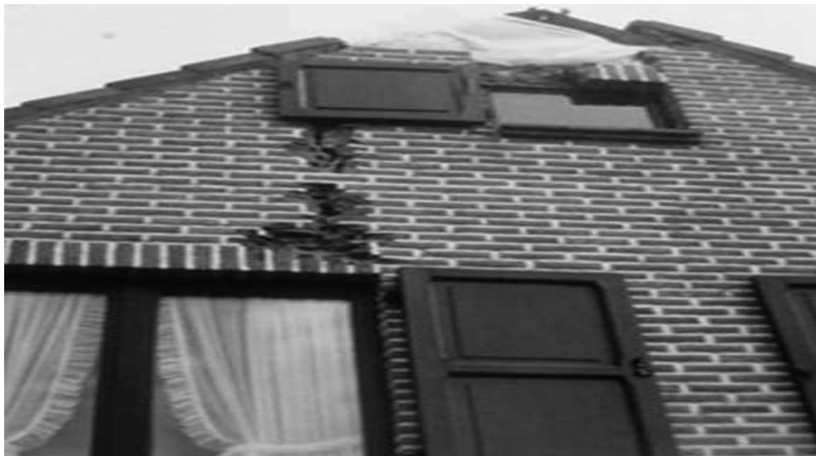
Figure. I-6: Façade foudroyée et lézardée par la violente onde de pression accompagnant l'éclair [ 9].
