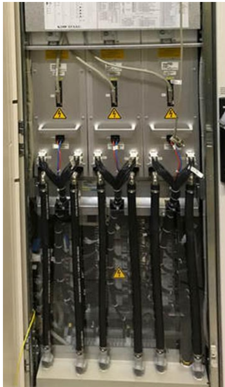
FigureII.4 : une photo à l'intérieur des armoires.
