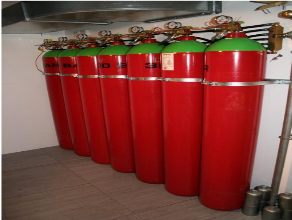
Figure I-4 : Bouteilles d'argon d'une installation d'extinction automatique à gaz pour salles de serveurs informatiques.
