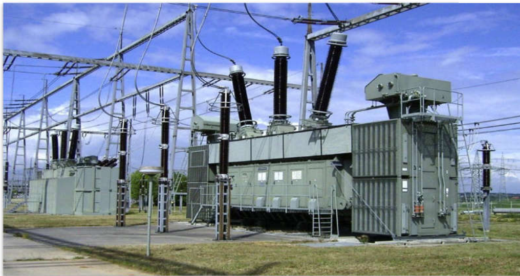
Figure I.6: transformateur de puissance
