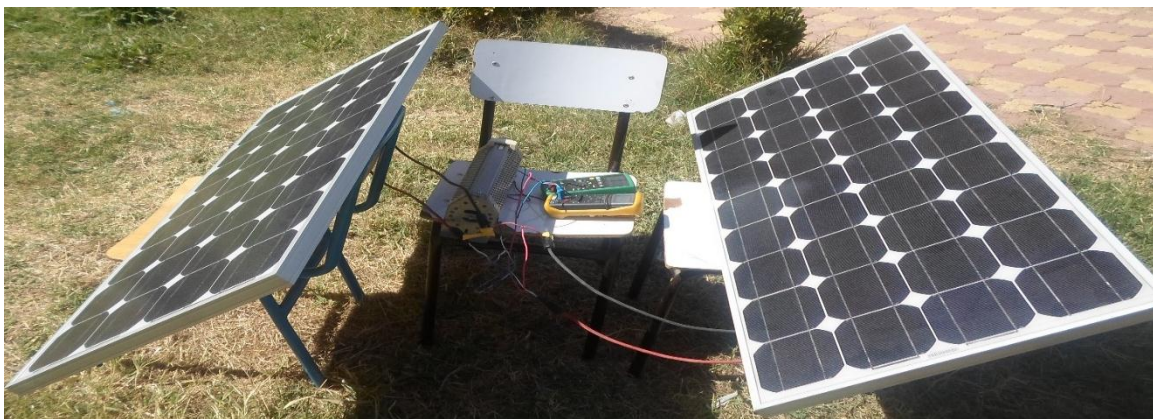
Figure 1.18 : La réalisation pratique de deux modules photovoltaïques en parallèle de 80 W.
