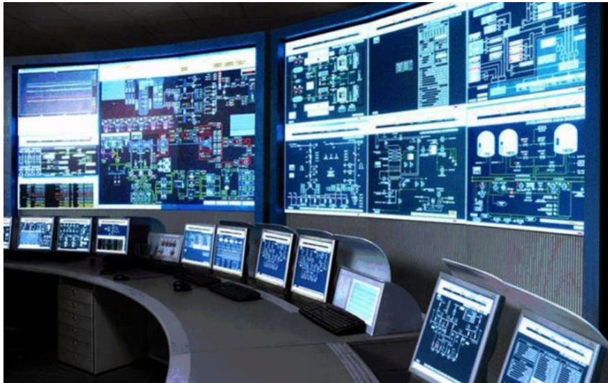
Figure III -1 : Poste de pilotage d'une supervision [55]
