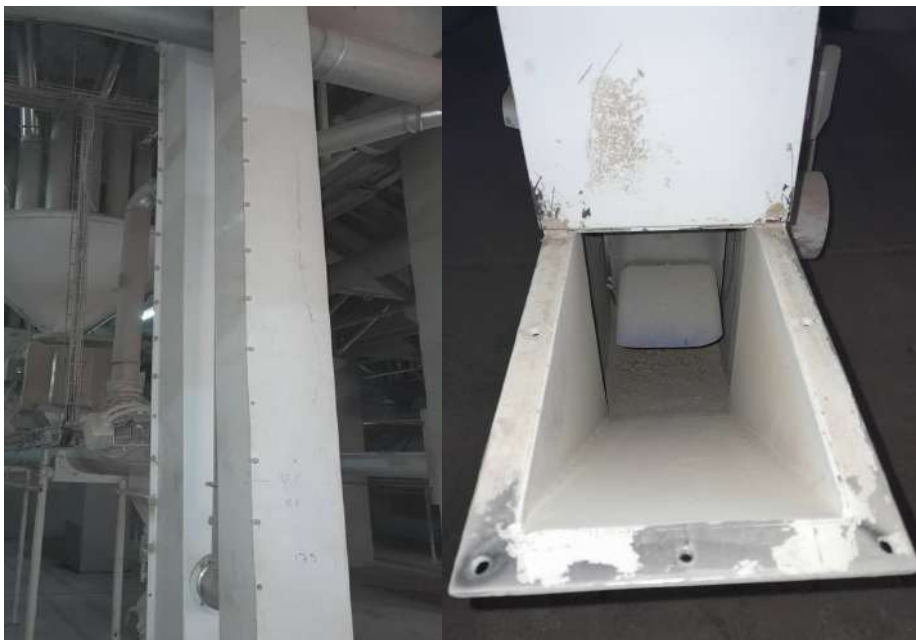
Figure 36 : Elevateur verticale pour le transport de blé.
