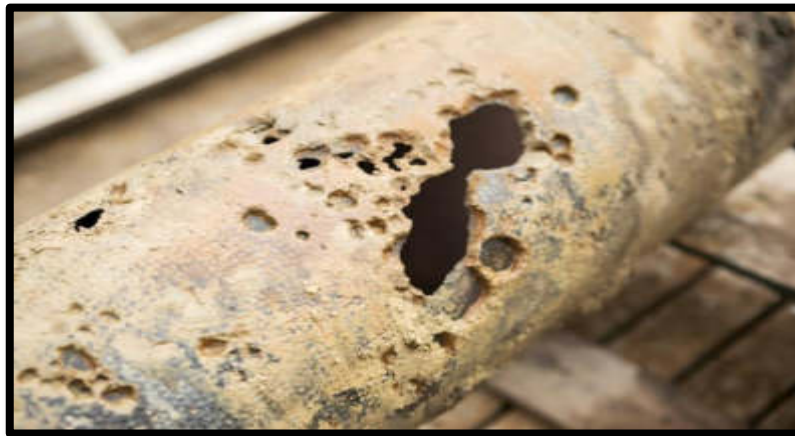
Figure I.2: Corrosion par piqûre (cas réel)
