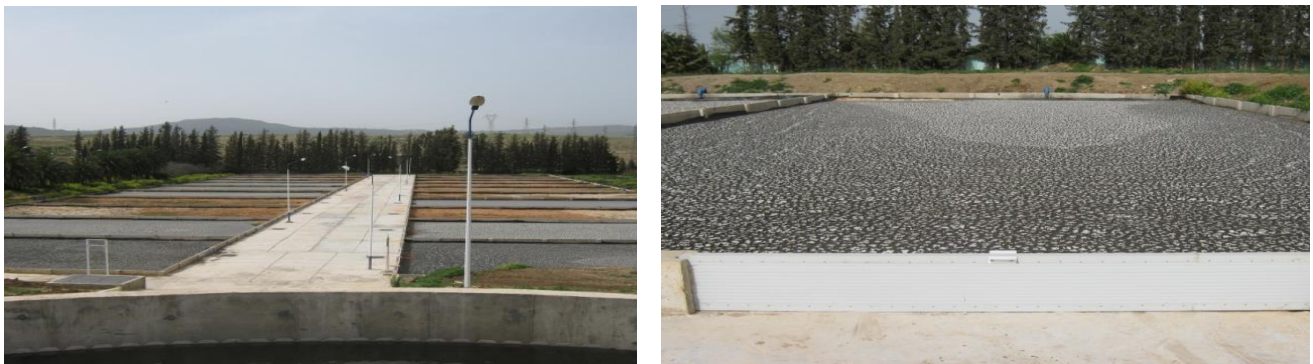
Figure II.13: Déshydratation des boues sur lits de séchage.
