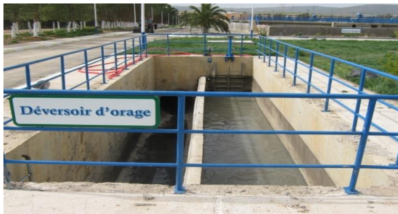
Figure II.5 : Déversoir d'orage (ONA, 2025).
