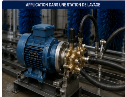
Figure I.10 : Moteur de Pompe Haute Pression
