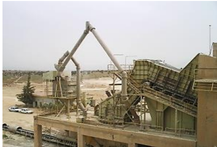
Figure I.3 : Concasseur au niveau de la carrière de calcaire de la cimenterie de Saida
