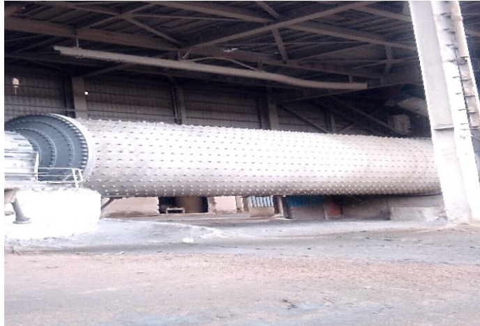
Figure I.8 : Broyeur clinker de la cimenterie de Saïda.
