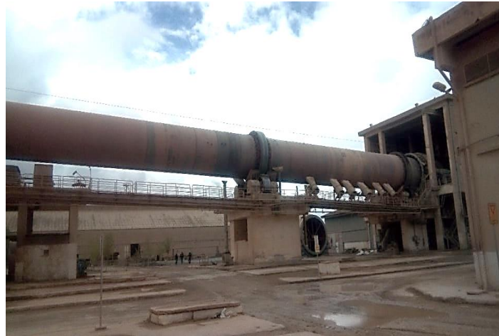
Figure I.6: Four rotatif de la cimenterie de Saida.
